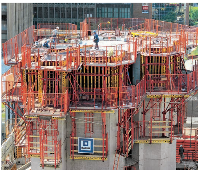
Costruzione di un edificio multipiano a Parigi con VARIO GT 24 e il sistema di ripresa CB 240.
