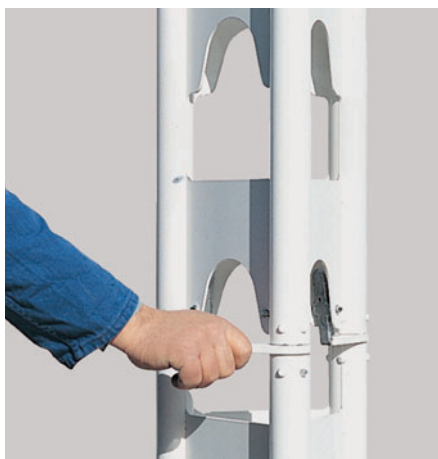
... e collegarlo al segmento di puntone sotto- stante mediante l'attacco con testa a martello.
