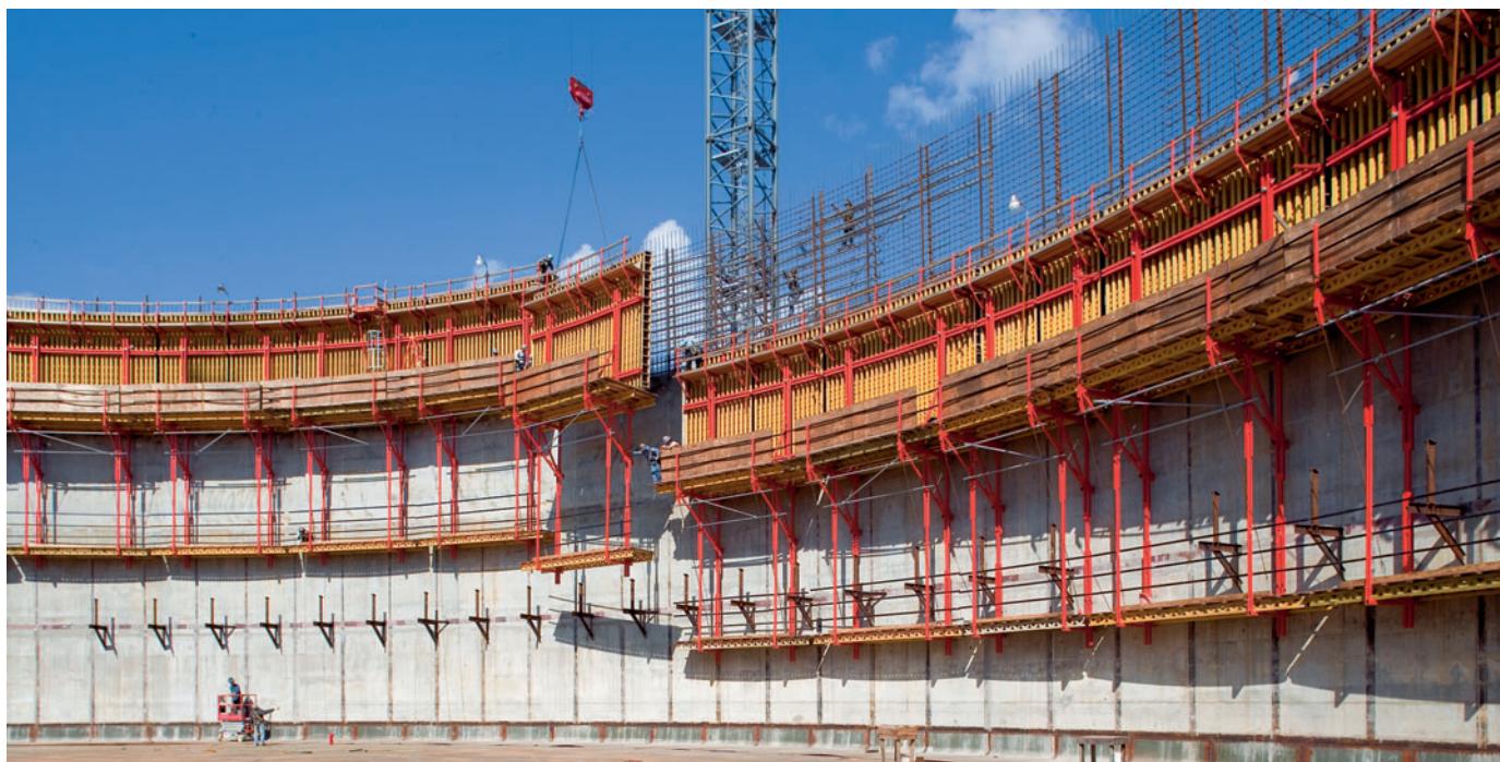
Serbatoio per gas liquefatto LNG Pareti circolari \varnothing 77,50 m con CB 240 e VARIO GT 24.
