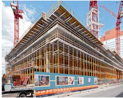
Lavorare in sicurezza lungo i bordi liberi dei solai
