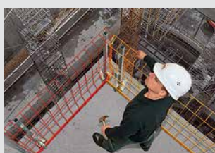
Sistemi di sicurezza
