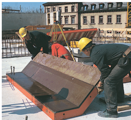
Elementi con angolo di 135° rivestiti con pannelli a grande superficie, utilizzati nella costruzione di un albergo.
