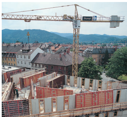
Elementi di lunghezza 9,00 m e altezza 2,70 m rivestite con pannelli di grande dimensione.
