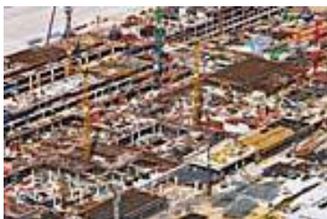
Figura 2: In soli dodici mesi, BAM Deutschland AG costruirà le strutture al rustico del terminal passeggeri. 30 gru e circa 800 persone che lavorano su due turni per poter rispettare le scadenze. (Fotografia: PERI GmbH)
