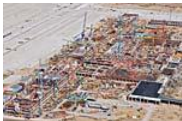
Figura 1: Soltanto osservandolo dall'alto si può avere un'idea delle dimensioni del cantiere: la struttura finale coprirà una superficie complessiva pari a 2.000 campi da calcio. (Fotografia: PERI GmbH)
