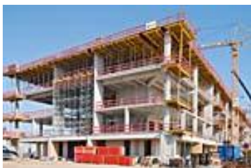
Figura 5: Qualora lo richieda l'altezza dei solai, le casseforme vengono puntellate con elementi di sistema PERI UP. (Fotografia: PERI GmbH)
