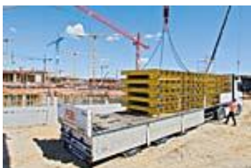
Figura 3: I ritmi serrati del cantiere richiedono enormi quantità di casseforme e strutture provvisorie, da consegnare in tempi strettissimi. I tavoli per solai vengono preassemblati da PERI e consegnati al cantiere nell'esatto momento in cui devono essere utilizzati. (Fotografia: PERI GmbH)
