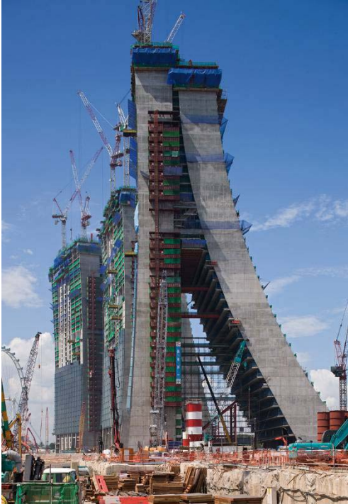
Foto 4 – La soluzione elaborata da PERI comprende casseforme e strutture provvisorie capaci di adattarsi alla particolare architettura delle tre torri a curvatura variabile e dei loro 55 piani sfalsati.
