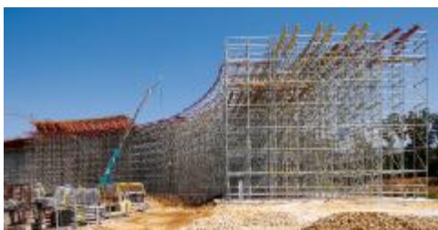
Figura 4: L'altezza di supporto della struttura PERI UP è poco meno di 15 m.
